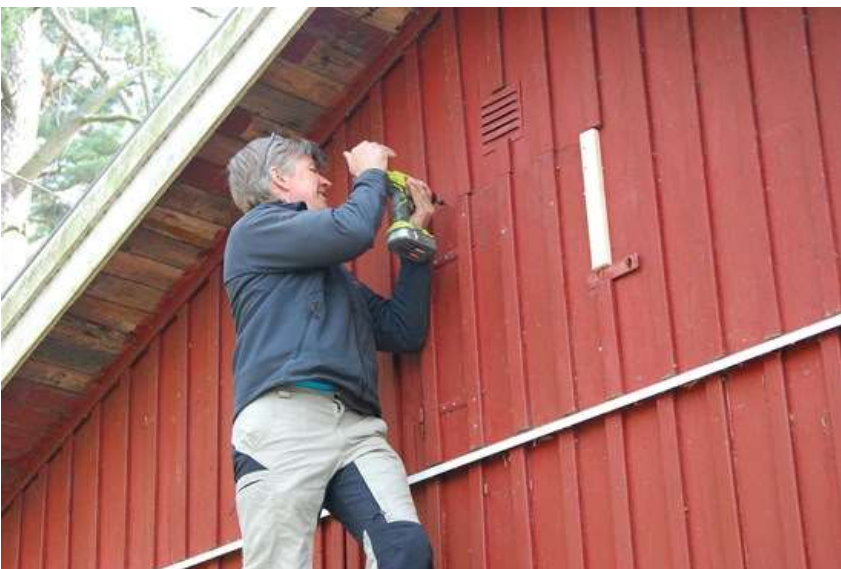
Fredrik monterar luckan till vinden som genomgått rejäl reparation. Kort efter bilden togs blev luckan målad röd.
